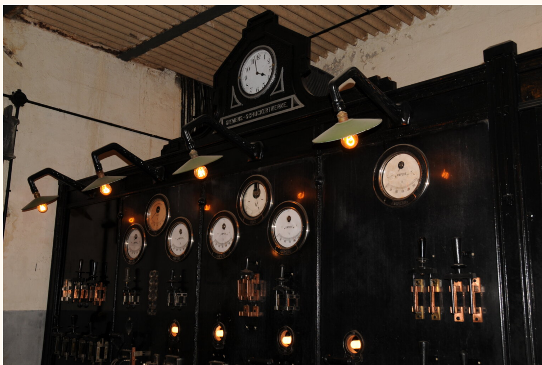
Terminal de contrôle de la centrale électrique de la forteresse Kaiser Wilhelm II (Fort de Mutzig, 1893), produite par l'entreprise Siemens-Schuckert. Ce fort rassemble une foule d'innovations de la fin du XIX e siècle mises au service de la logique de guerre (électricité, télécommunications, armement...). Photographie : Thomas Bresson , CC-BY 3.0 (Wikimédia), 2010.
